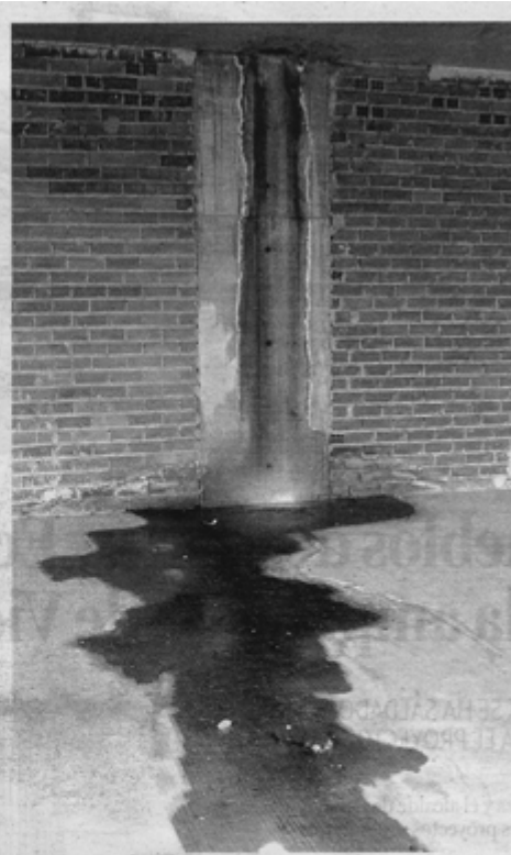
Rastro de humedad que sale de las viviendas. FOTO: SANDRA LATORRE
